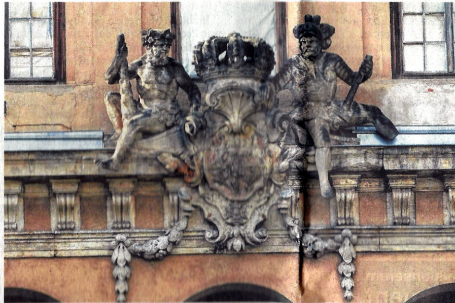
Die Wappen an der Straßen- und der Gartenseite sind ein besonderer Gefahrenherd, sie sollen nun abgebaut und gesichert werden. Fotos (2): Dietrich Flechtner
